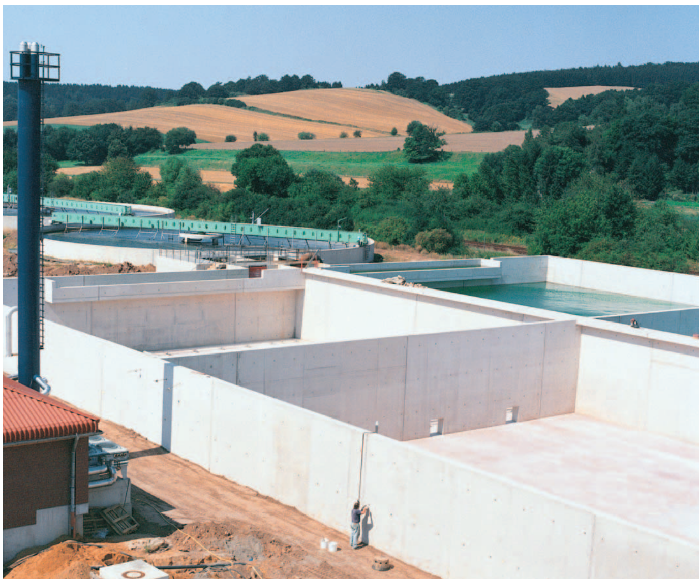
Renseanlegg i Hameln, Tyskland.
